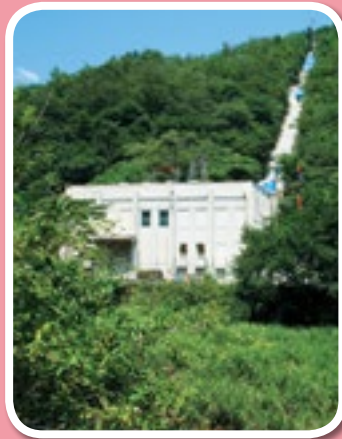
▲ 明知川発電所(上部図解C) ※水圧鉄管の取替工事中の発電所
