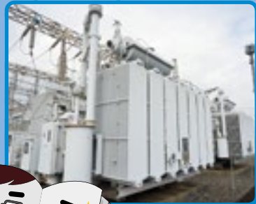
末広変電所 (三重県鈴鹿市)
