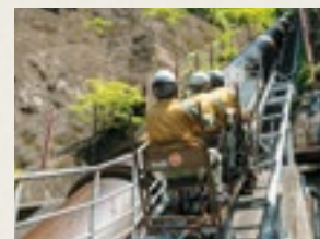
水槽に貯められた水は、「水圧鉄管」(写真モノレール左側)を通り、発電所内の水車を回し、発電機を動かします。 ※交流 No.111「でんペディア」参照
