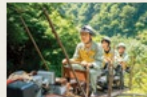
発電所の上に設置された水槽や水圧鉄管の点検時に使用する作業用モノレール
