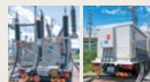
豊野変電所では、被害を受けた変電設備の復旧計画を進めながら、今も変圧器車とキュービクル車によって、電力供給が行われている。(左/変圧器車・右/キュービクル車)
